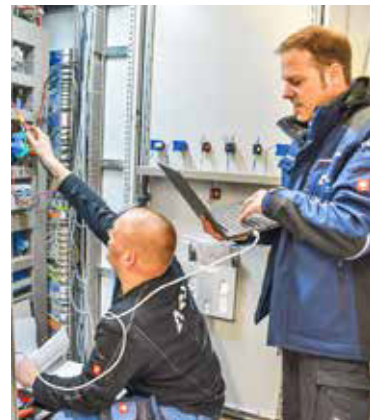
Stefan Baasch (li.) und Birger Kanieß am Schaltschrank des neuen BHKW
