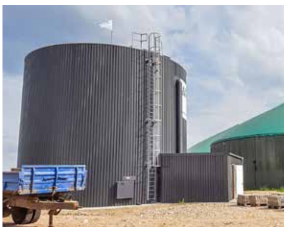
Bei einem Betrieb der Anlage zu Spitzenbedarfszeiten nimmt der große Speicher die anfallende Wärme auf.
